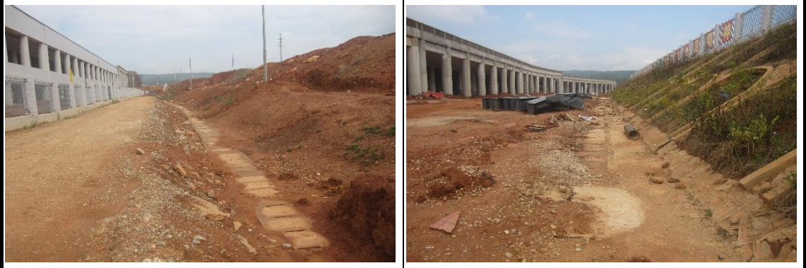
大板桥车辆段区浆砌石盖板排水沟
