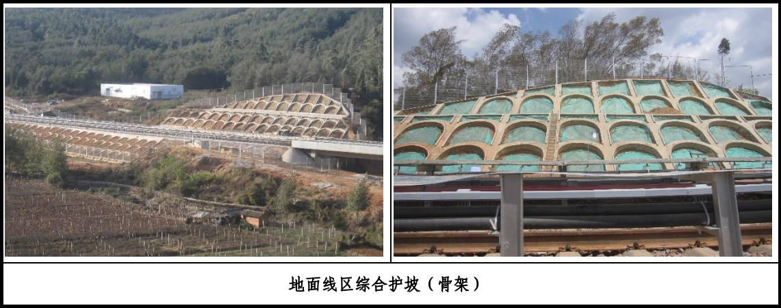
图 4-1 工程已部分实施的水土保持措施现状
