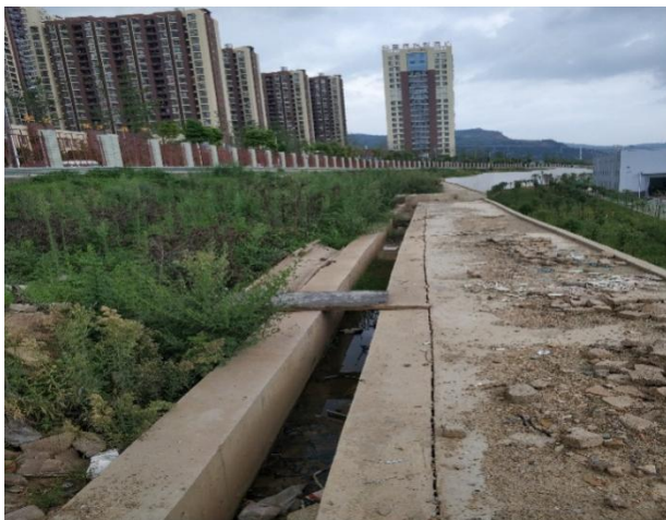
混凝土截水沟（大漾田车辆段）
